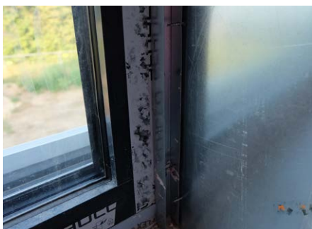
(3) Stahlplatte an Schwert liegt in Hohllage und kann zu unerwünschten Resonanzeffekten führen.
