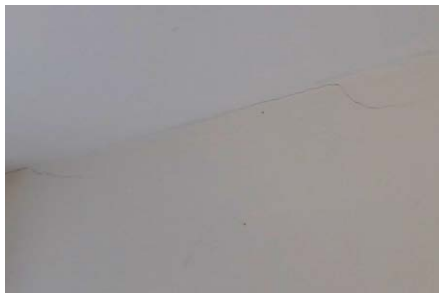
(9) Mäandrierender Riss im Übergang von Deckenfläche (Kehlbalkendecke) zu massiver, nicht tragender Innenwand
