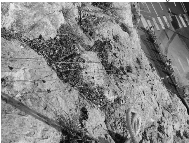
Abb. 3: Stahlseile melden jede Rissbewegung am oberen Ende des Hangs befindlichen X-Trigger.
