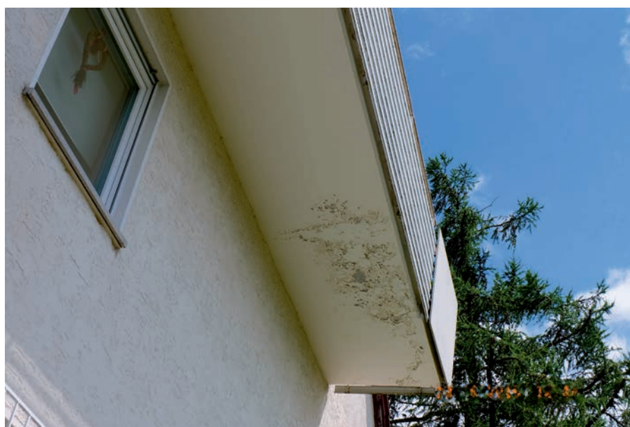
(5) Sanierungsbedürftiger Balkon mit defekter Abdichtung und karbonatisierten Brüstungselementen
