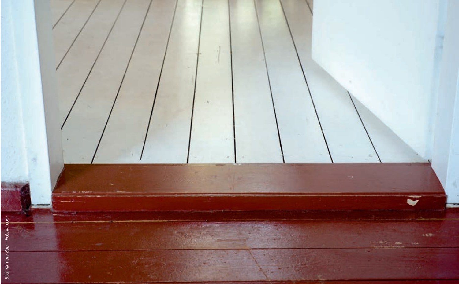
Bild: © Yuri Zap – Fotolia.com (1) Türschwellen wie diese sind in den meisten Bestandsgebäuden gang und gäbe. In modernen Neubauten würden sie als unerwartete Stolperfalle gelten. Die Beurteilung einer Schwelle als Stolperstelle hängt also von den Umständen ab.
