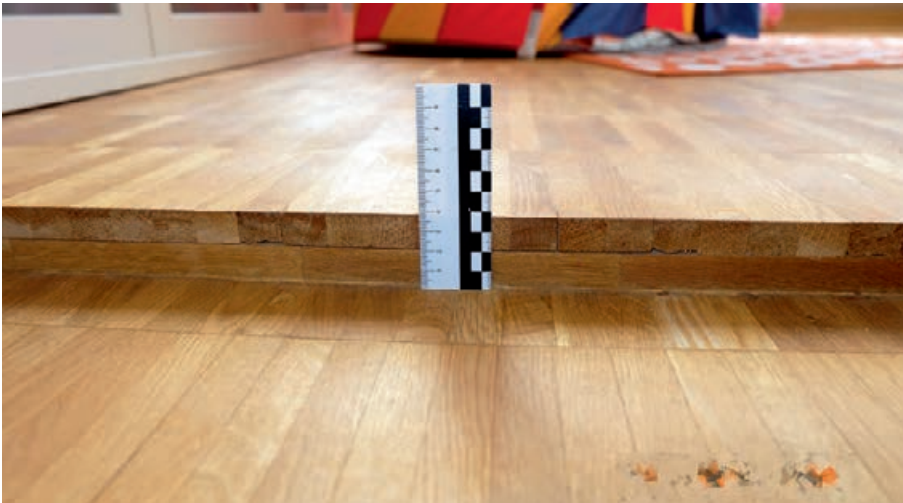
(2) Stufung von 38 mm mitten im Fußboden eines Raums wegen unterschiedlichen Höhenniveaus eines von Anbaus (Alternative: Verlust an Raumhöhe)
